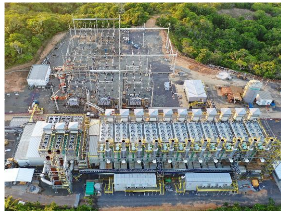
Termelétrica Prosperidade I, II e III Imetame Energia Mata de São João, BA (Juntas geram 132 MWh)
